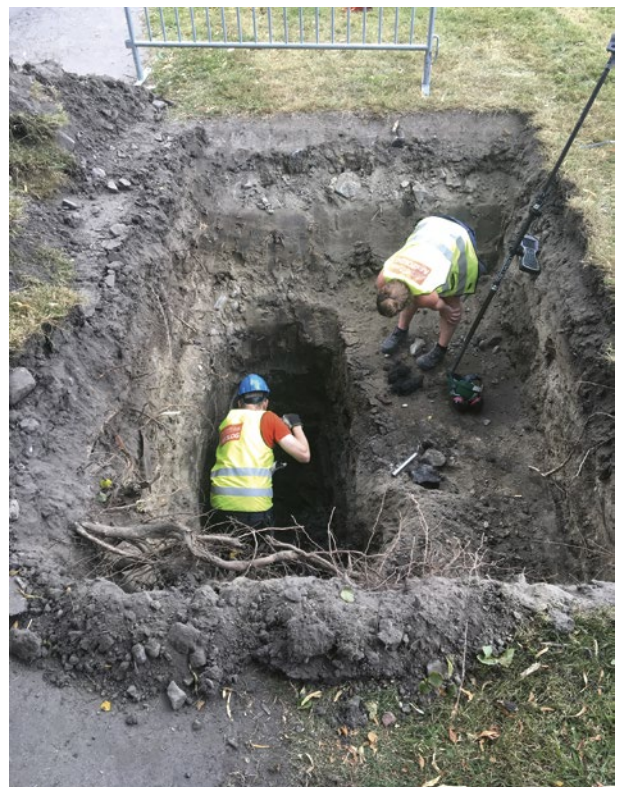
Figur 12. Grävande av schakt 6. Här syns tydligt hur djupt det blev och varför lagren inte kunde följas till botten. Foto från norr: Per Johansson.
